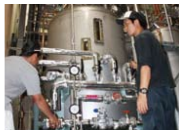
蒸留所の試運転の様子。発酵させた原料(サトウキビ)をここで蒸留する。
